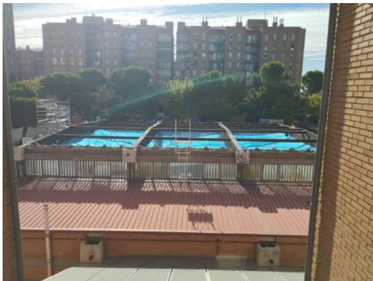
Cubierta del gimnasio retirada. No se puede acceder y todo el perímetro está acotado.
