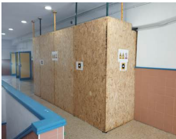
Hueco del ascensor acotado para impedir el acceso.
